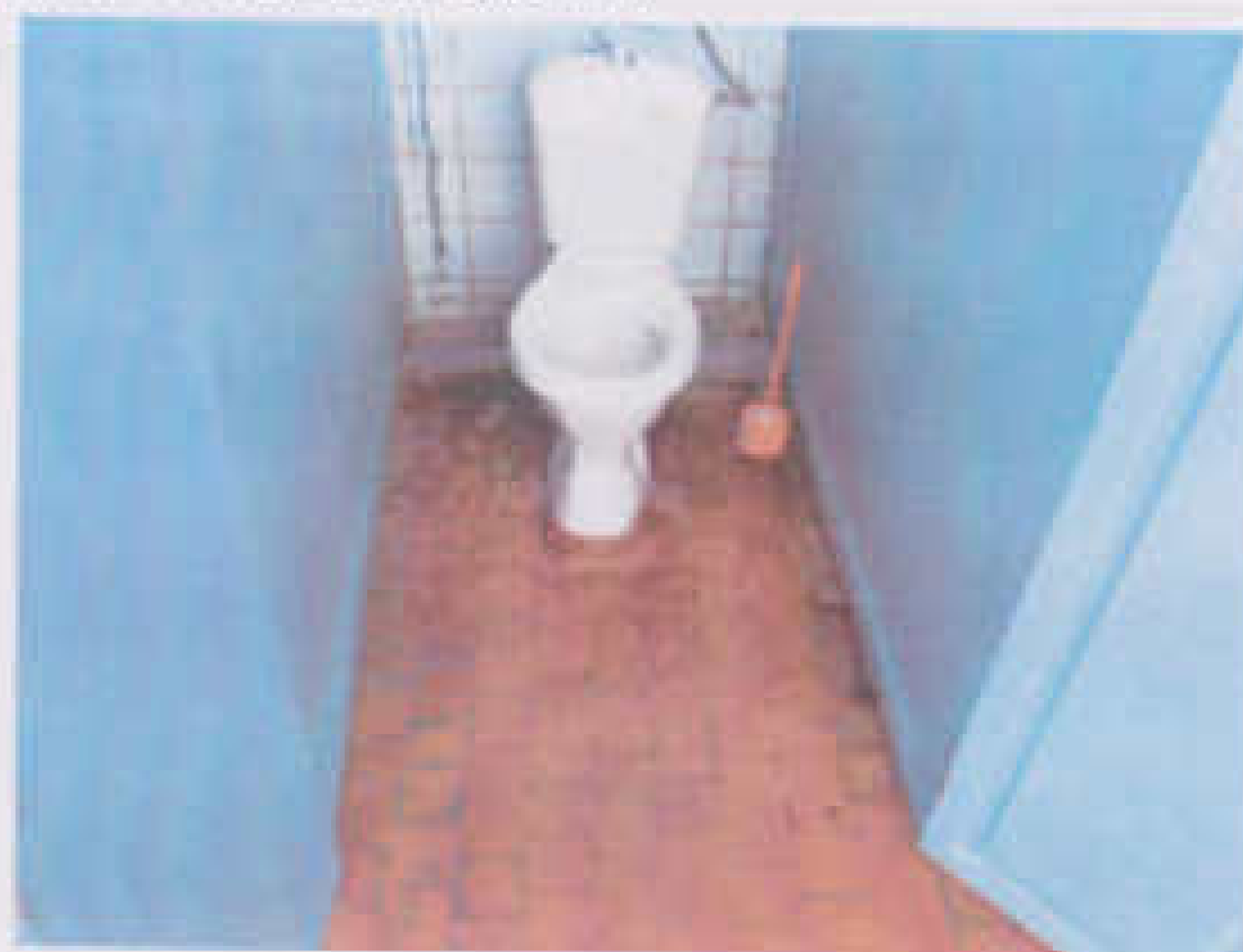
Фото 29 Туалетная комната (унитаз, кабинка)
