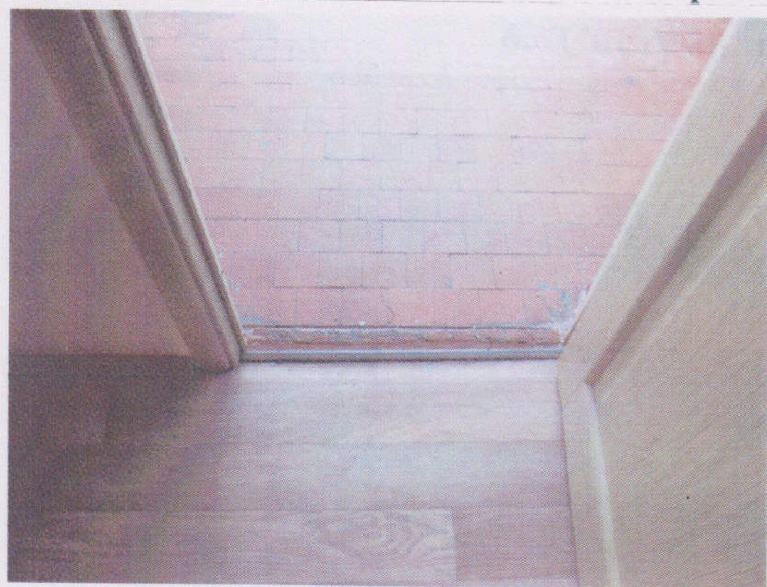
Фото 28 Туалетная комната (дверь)
