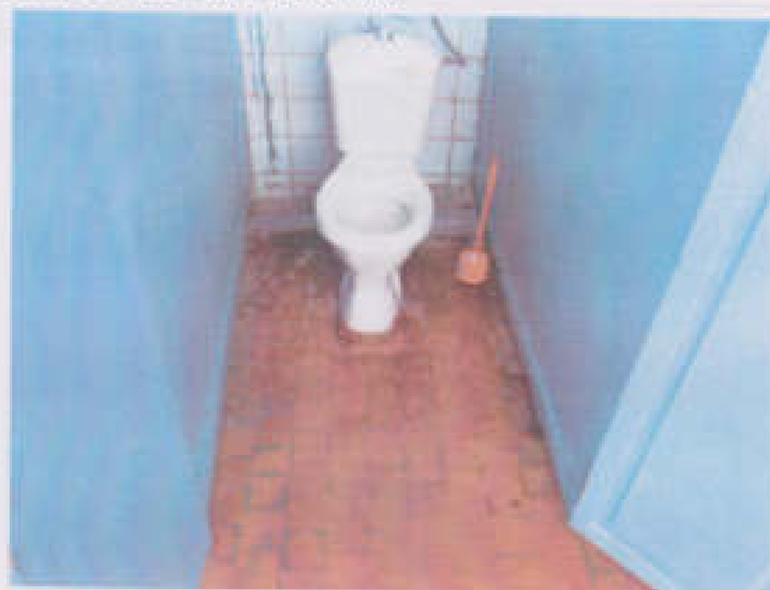
Фото 29 Туалетная комната (унитаз, кабинка)
